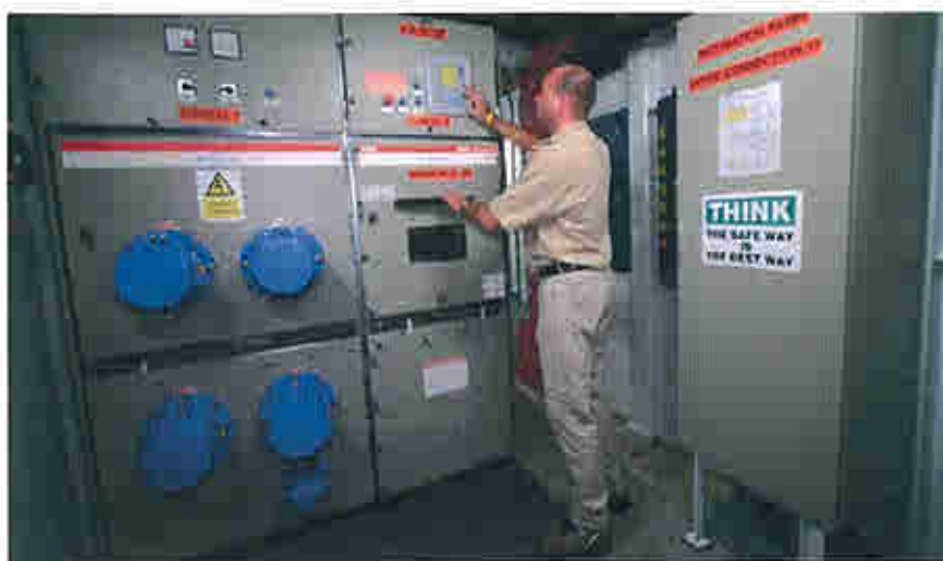
Figuur 6.3 een foto van een schakelkast voor walstroom aan boord van een zeeschip 42
