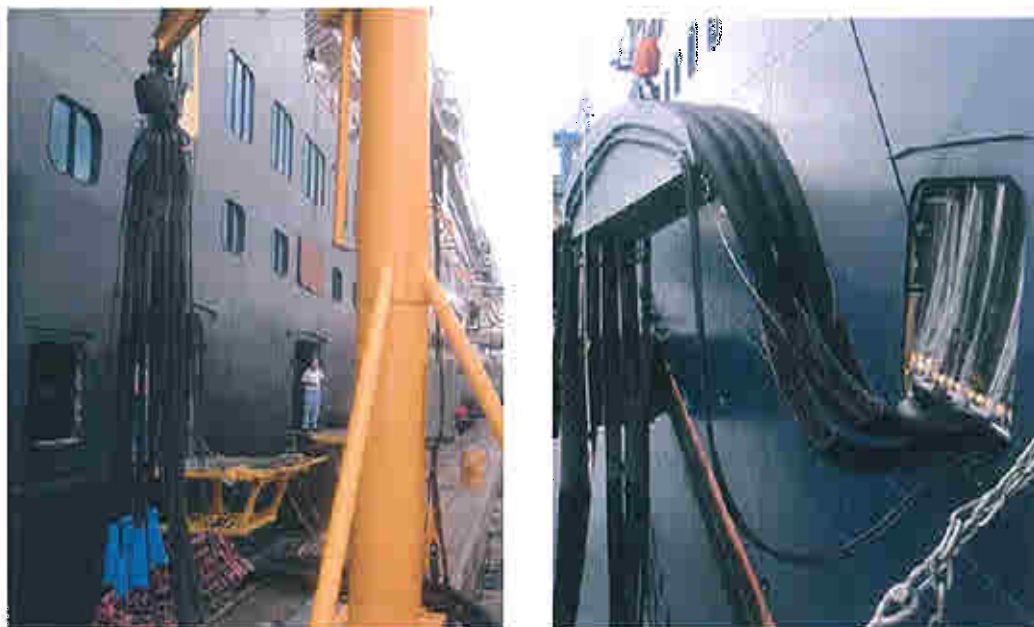
Figuur 6.1 en 6.2 Een flexibele 27kV elektriciteitskabel wordt aan boord van een zeeschip gehesen voor een walstroom aansluiting 35
