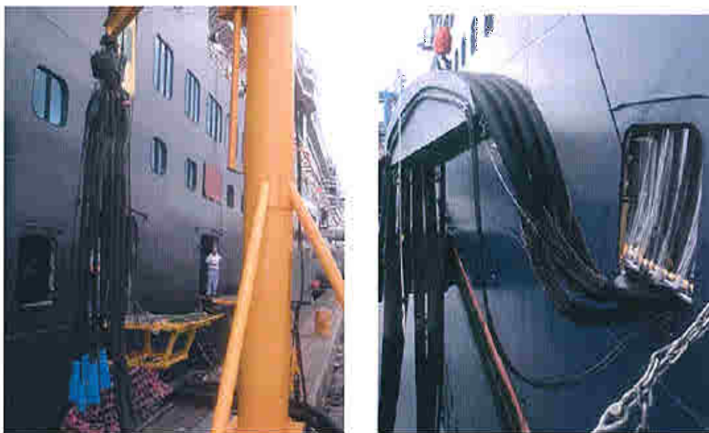
Figuur 6.1 en 6.2 Een flexibele 27kV elektriciteitskabel wordt aan boord van een zeeschip gehesen voor een walstroom aansluiting 37
