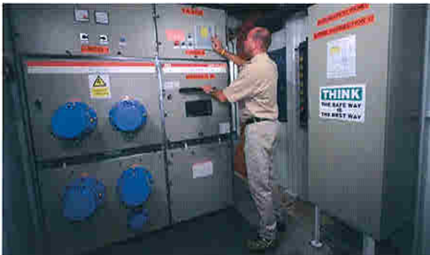
Figuur 6.3 een foto van een schakelkast voor walstroom aan boord van een zeeschip 44
