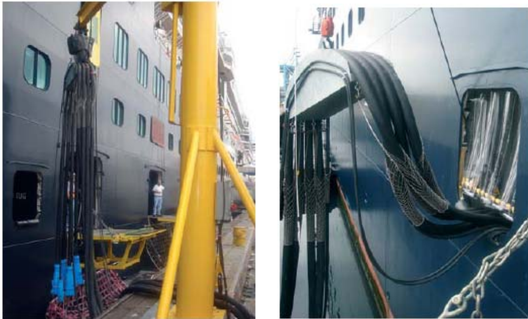
Figuur 1. Een flexibele 27kV elektriciteitskabel wordt aan boord van een zeeschip gehesen voor een walstroom aansluiting 20
